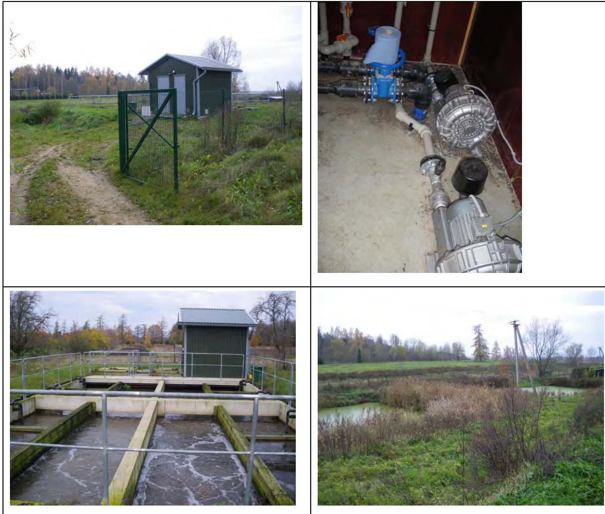
Joonis 3. Vana-Vigala küla rooveepuhasti. Fotod: OÜ Alkranel 27.10.2011.
