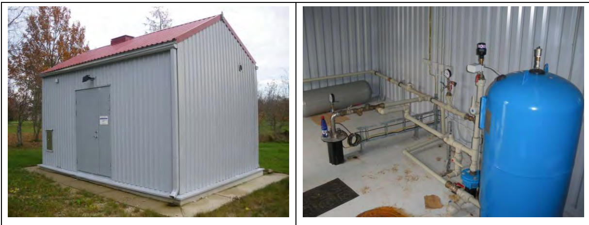
Joonis 4. Kivi-Vigala küla kooli puurkaev-pumpla (katastri number 9062). Fotod: OÜ Alkranel 27.10.2011.
