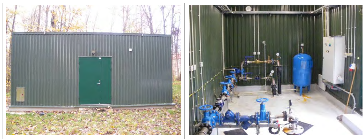
Joonis 2. Vana-Vigala küla puurkaev-pumpla (katastri number 9040). Fotod: OÜ Alkranel 27.10.2011.
