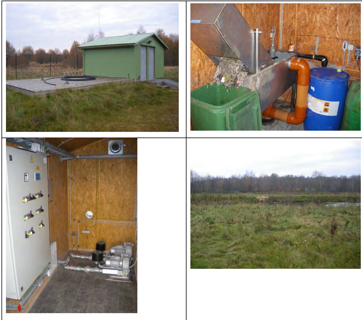
Joonis 5. Kivi-Vigala küla reoveepuhasti. Fotod: OÜ Alkranel 27.10.2011.
